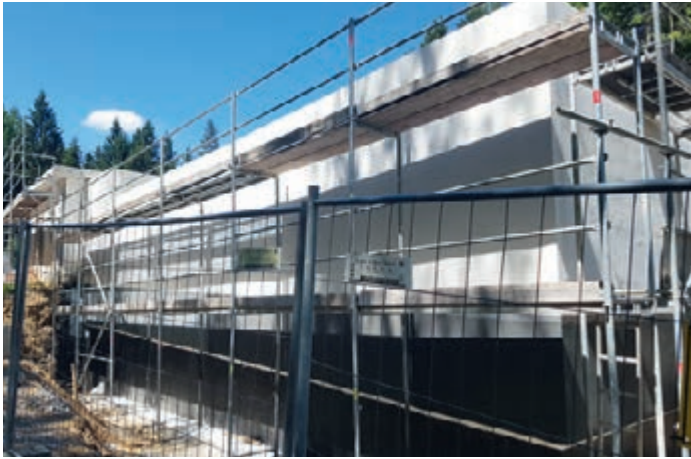
Speicherammer am Hochbehälter List
